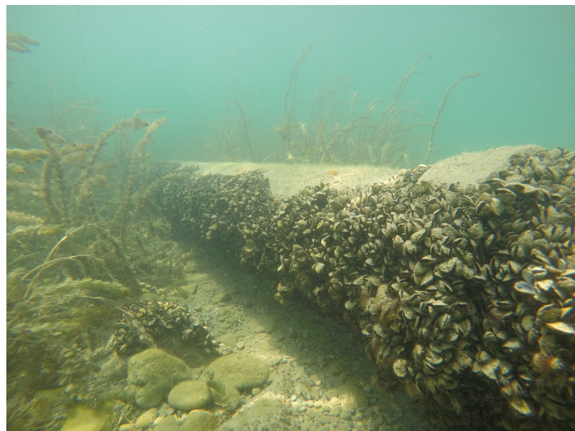
Die Quagga-Muschel bedroht im Bodensee nicht nur das ökologische Gleichgewicht, sondern lagert sich auch auf Infrastrukturbauten ab.
